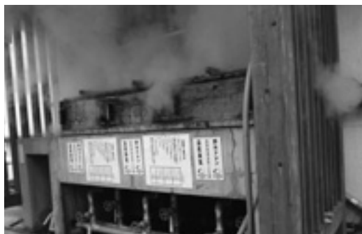
写真1. 地獄蒸し釜の外観
